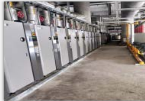
天然氣貫流式鍋爐(18台2.5噸)
